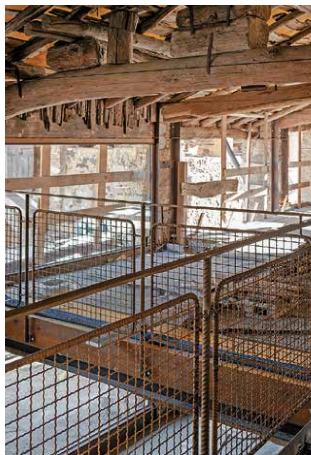
Negli edifici recuperati parti vecchie e parti nuove sono entrambe visibili. (Marcelo Villada)
