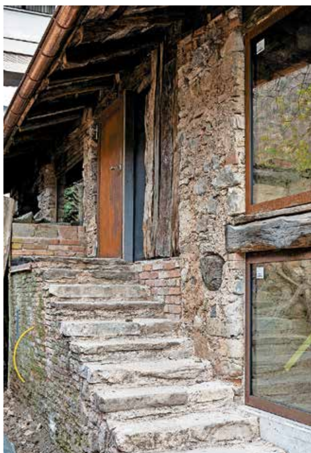
Il riutilizzo del materiale laterizio è fra i principi del restauro conservativo degli stabili. (Marcelo Villada)
